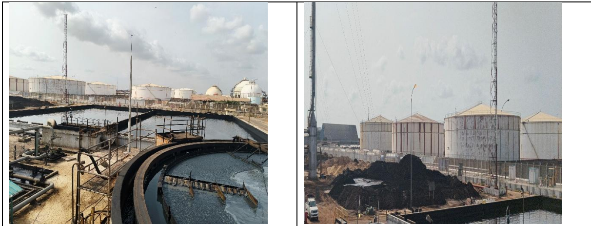
Photographie 4 : Station de traitement des eaux et boue en cours de traitement
