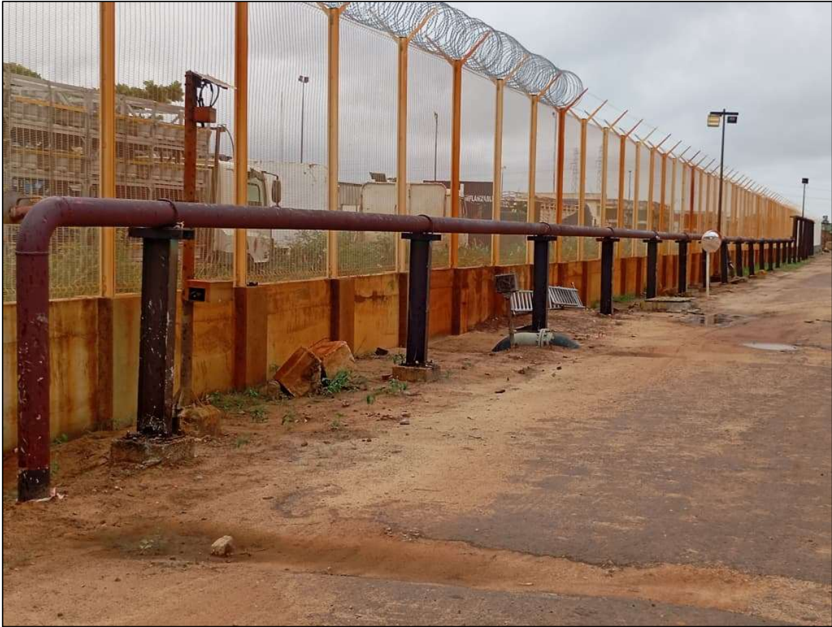
Annexe 86 : Rideau d'eau au niveau de la clôture U65
