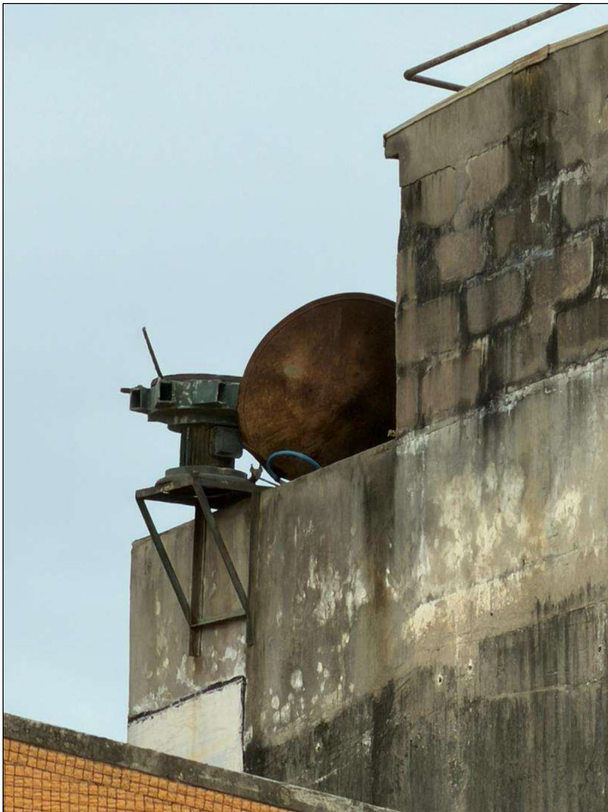
Sirène sur le toit du bâtiment des achats
